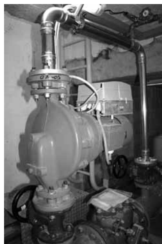
Déi nei installéiert Pompel
